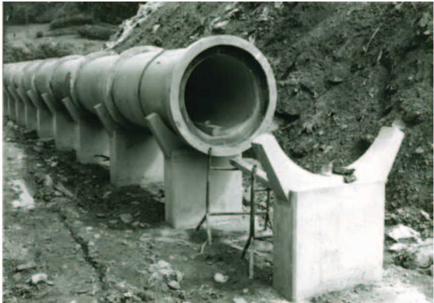
Collecteur de transit de la station d'épuration de Sainte-Marie-aux-Mines
