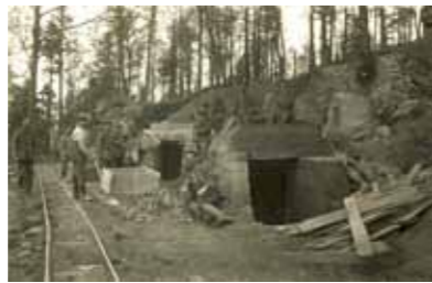
Construction de blockhaus. Les matériaux nécessaires sont acheminés par le réseau de transport militaire
